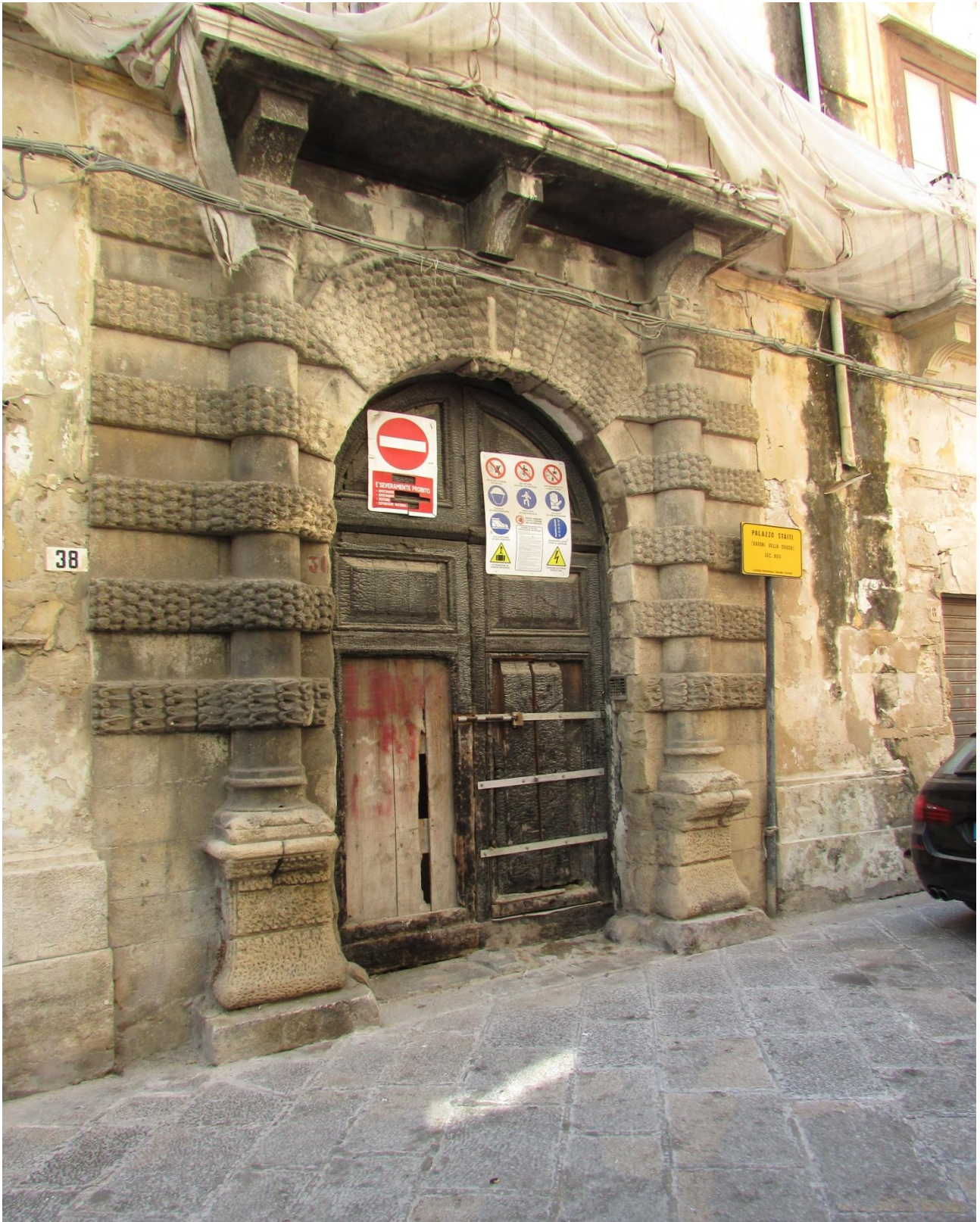
Palazzo di Girolamo Staiti Barone della Chiusa, in Via Mercè, in totale degrado (Foto L.S.)
