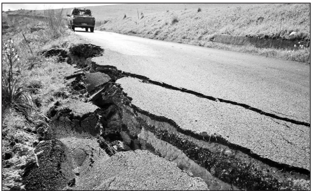
Una delle strade interne danneggiate dalle piogge intense dei giorni scorsi
