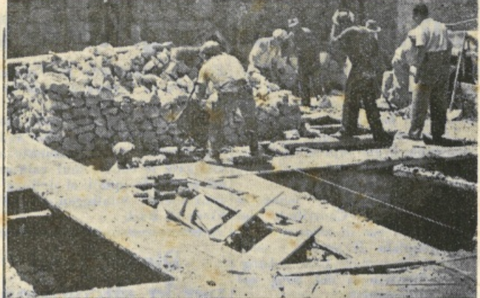
A CURA DEL GENIO CIVILE. - Ricostruzione dell'edificio dell'Archivio di Stato. Lavori di fondazione in corso. (Progetto Ing. Salvo. Impresa Paolo Benivegna Gianquinto). (Fotografie Bonventre)
