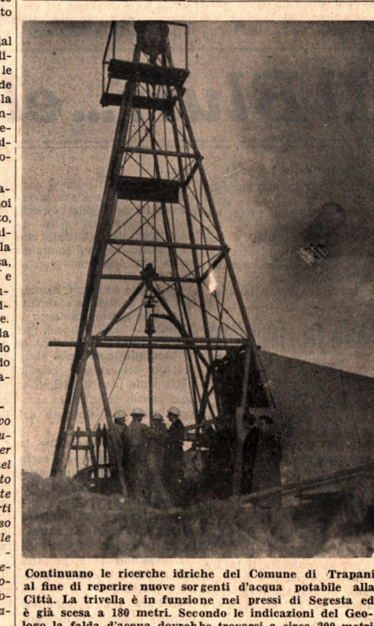
Continuano le ricerche idriche del Comune di Trapani al fine di reperire nuove sorgenti d'acqua potabile alla Città. La trivella è in funzione nei pressi di Segesta ed è già scesa a 180 metri. Secondo le indicazioni del Geologo la falda d'acqua dovrebbe trovarsi a circa 200 metri
