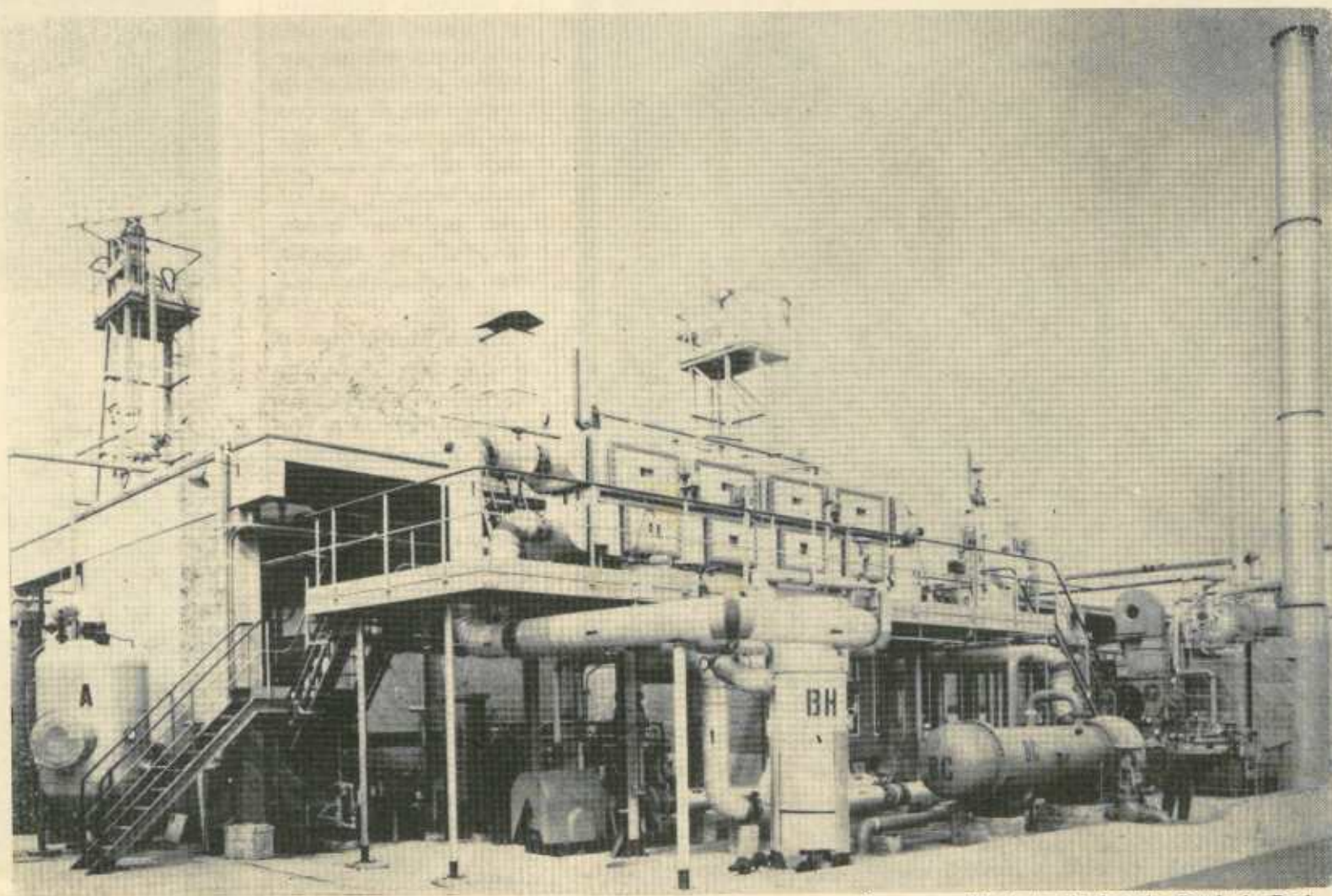
Impianto sperimentale di dissalazione multi flash, costruito dalla Breda Termomeccanica presso l'Istituto di Ricerche Breda in Bari
