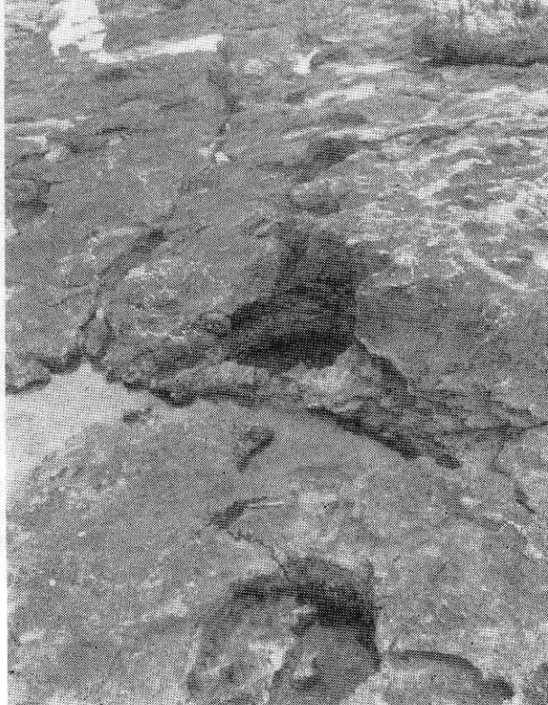
Fig. 2 a (sopra) - Fila di fori nella zona delle mareggiate
