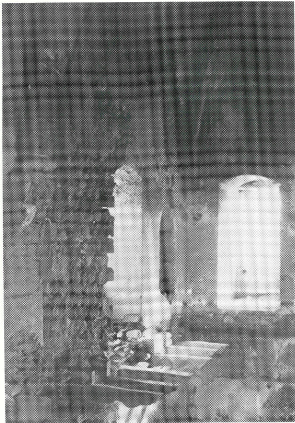
Fig. 46 - Finestre con volta ad arco ribassato e nicchia sui lati E e S del secondo piano.
