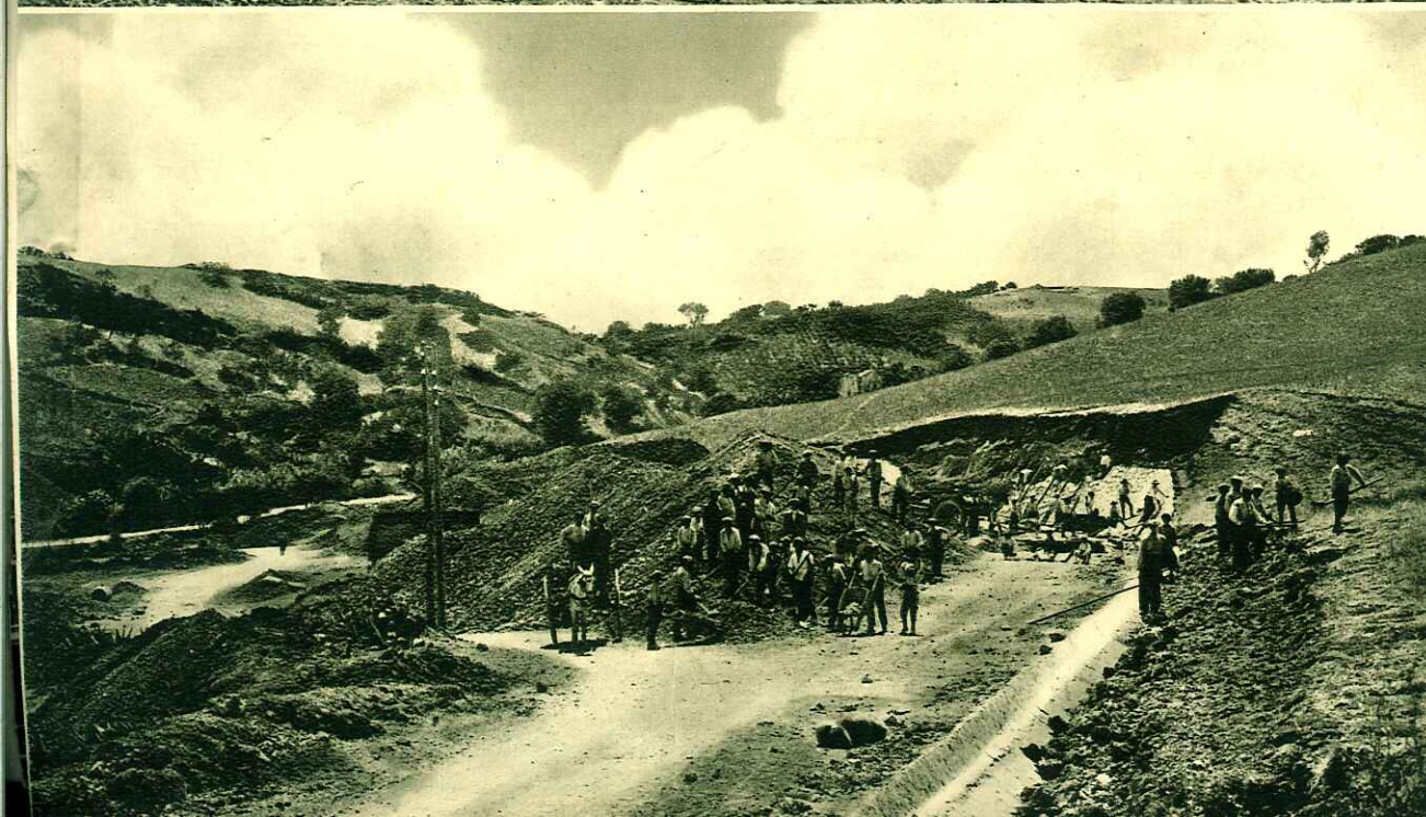
DEVIAZIONE DI UN TRATTO DELLA STRADA DI FIUME FREDDO E CONSOLIDAMENTO DI FRANA
