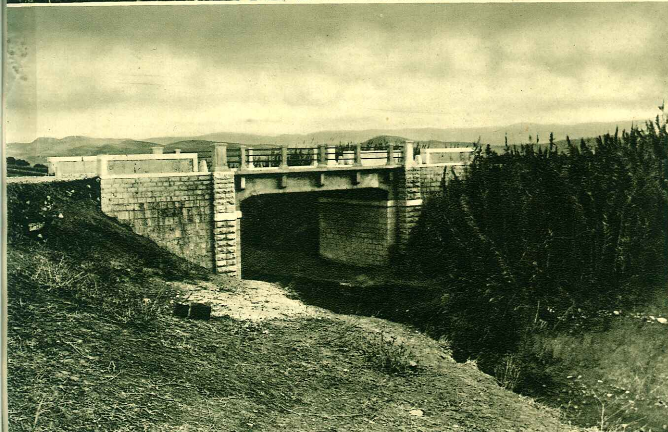
PONTE IN CEMENTO ARMATO DI M. 8 DI LUCE IN CONTRADA ROGNONE SULLA STRADA DI PASSOFONDO
