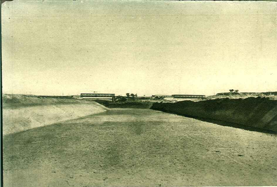
BONIFICA DEI MARGI DI BIRGI E DEL GORGO MARAUSA : INALVEAZIONE DEL TORRENTE BIRGI A VALLE DEL PONTE DELLA LINEA FERROVIARIA PALERMO-TRAPANI
