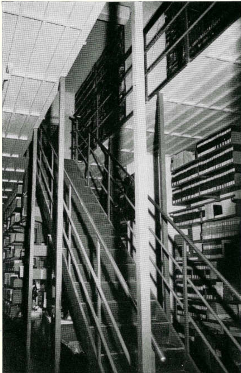
Una scala metallica collega il piano terreno con il piano superiore dell'impianto di scaffalatura metallica.
