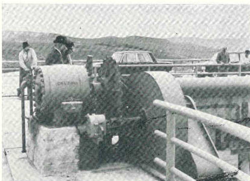
Le paratoie a settore automatiche che stanno all'imbocco dello scarico di superficie del serbatoio « Domenico Rubino » e che possono anche essere indotte con intervento meccanico e manuale
