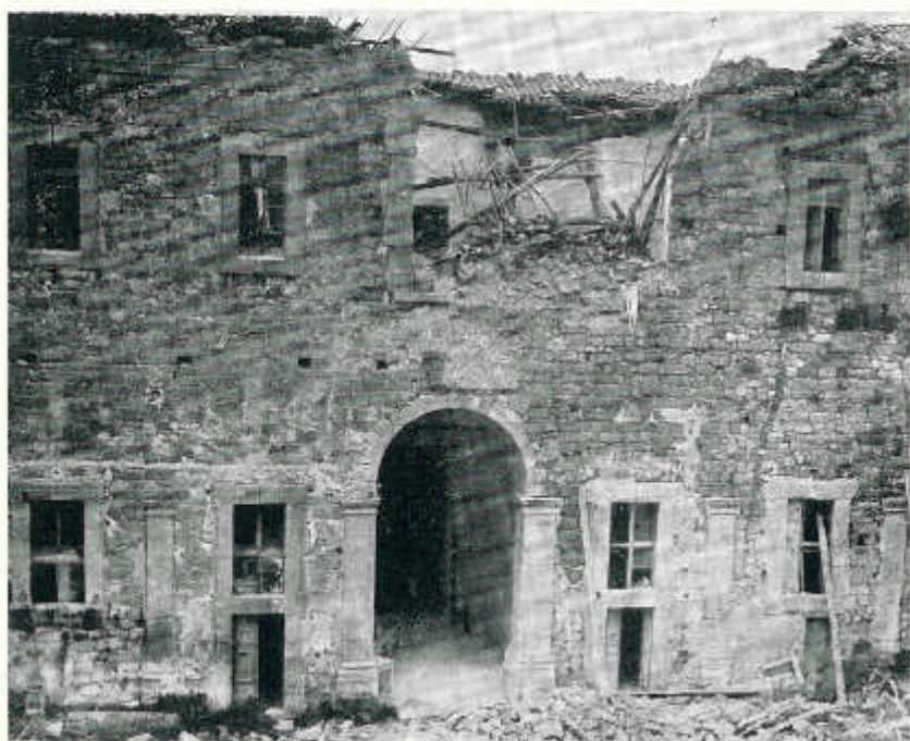
La facciata interna del Collegio: questo è il desolante aspetto dei muri crollati nel cortile sottostante, e tuttora in stato di completo abbandono
